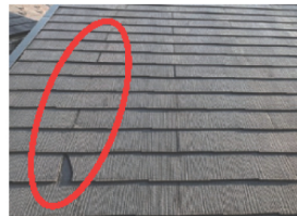
スレートの欠損
